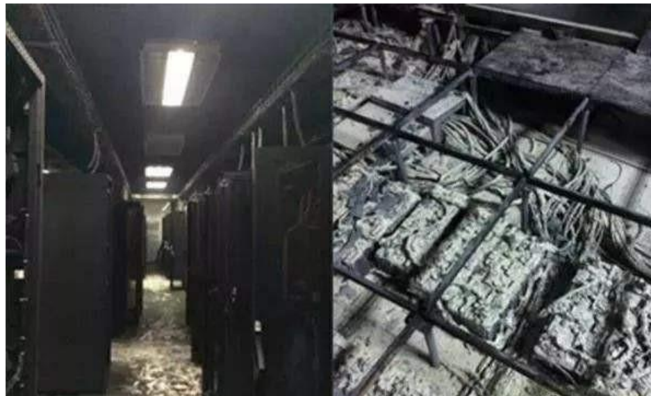
某机房蓄电池事故
